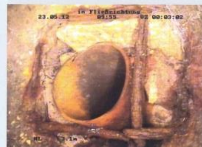
Bild 3: Nicht fachgerecht angeschlossener Zulauf mit GW-Zutritt
