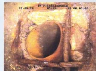
Bild 3: Nicht fachgerecht angeschlossener Zulauf mit GW-Zutritt
