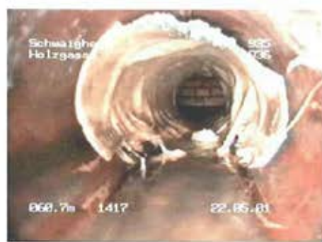
Bild 3 und 4 Nicht fachgerechte Sanierungen
