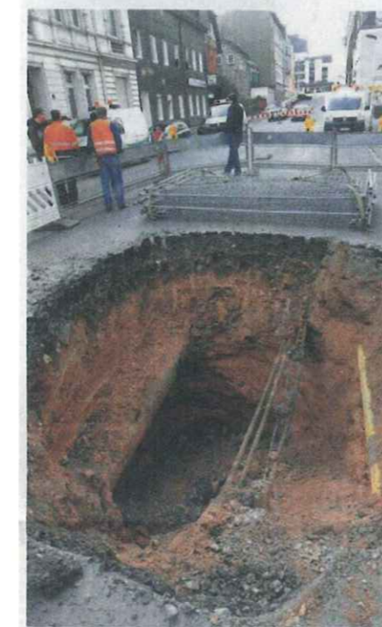
Etwa fünfzehn Meter ist das Loch in der Gasstraße an seiner tiefsten Stelle. Am Freitag sollten die Arbeiten mit dem Verlegen der neuen Kanäle komplett freigegeben werden.
