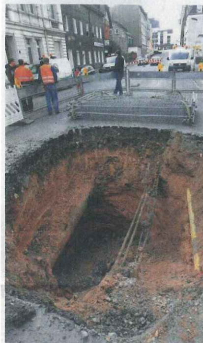
Etwa fünfzehn Meter ist das Loch in der Gasstraße an seiner tiefsten Stelle. Am Freitag sollten die Arbeiten im Bereich des Lochs komplett freigegeben werden.
