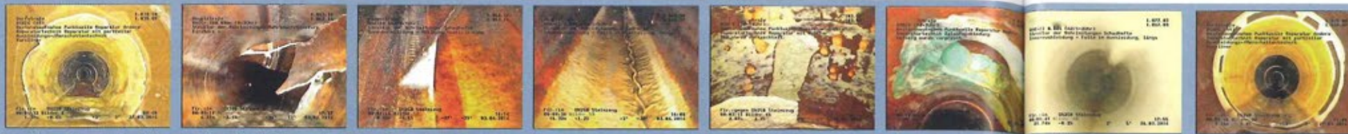
Qualitätsrelevante Ausführungsmängel beeinflussen die Lebensdauer einer Sanierungsmaßnahme.
